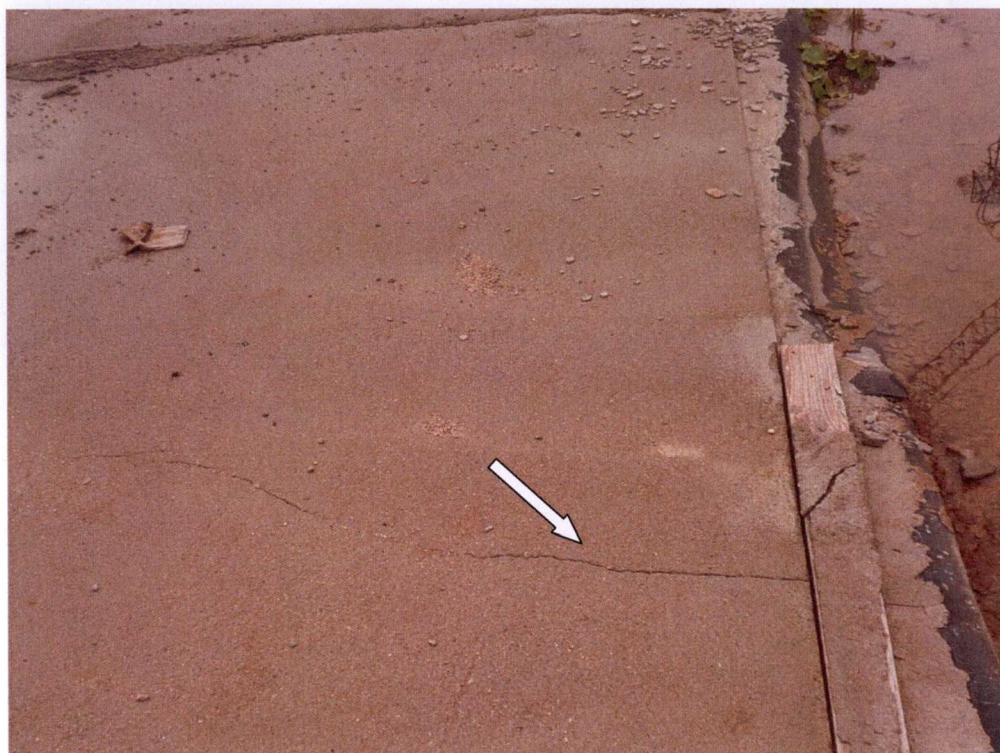
Фото № 15. Трещина в цементно-песчаной стяжке в зоне секций 4,5 раскрытием 1-3 мм
