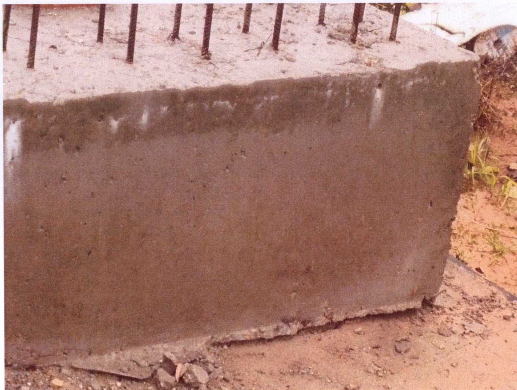
Фото № 12. Зазор между фундаментной плитой и цементно-песчаной стяжкой раскрытием до 20 мм в зоне секции 2
