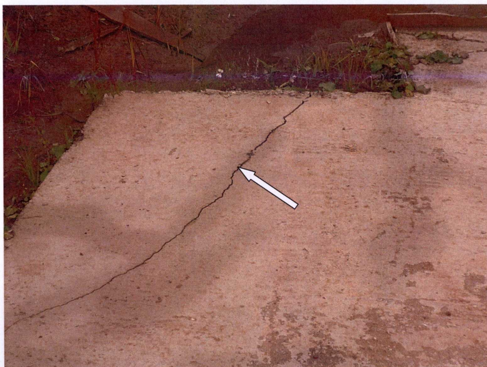
Фото № 3. Трещины в бетонной подготовке раскрытием 1-3 мм
