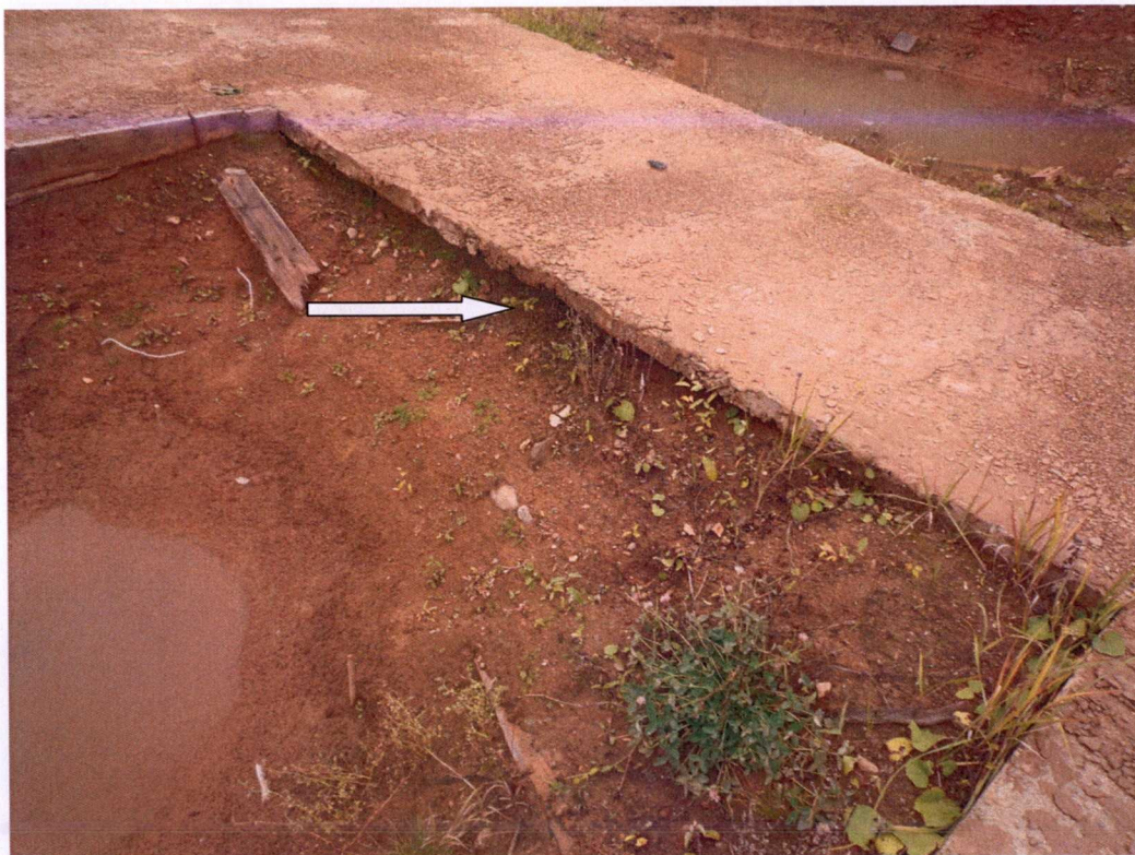
Фото № 5. Участок вымывания грунта из-под подошвы бетонной подготовки
