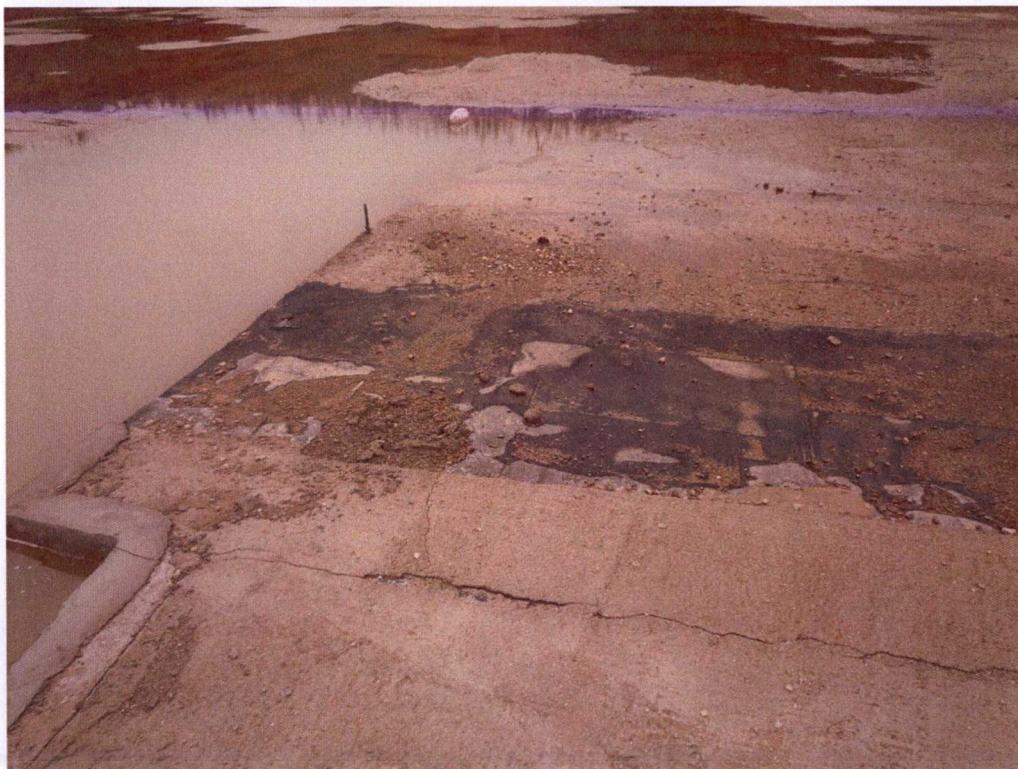
Фото № 18. Участок нарушенной гидроизоляции.
