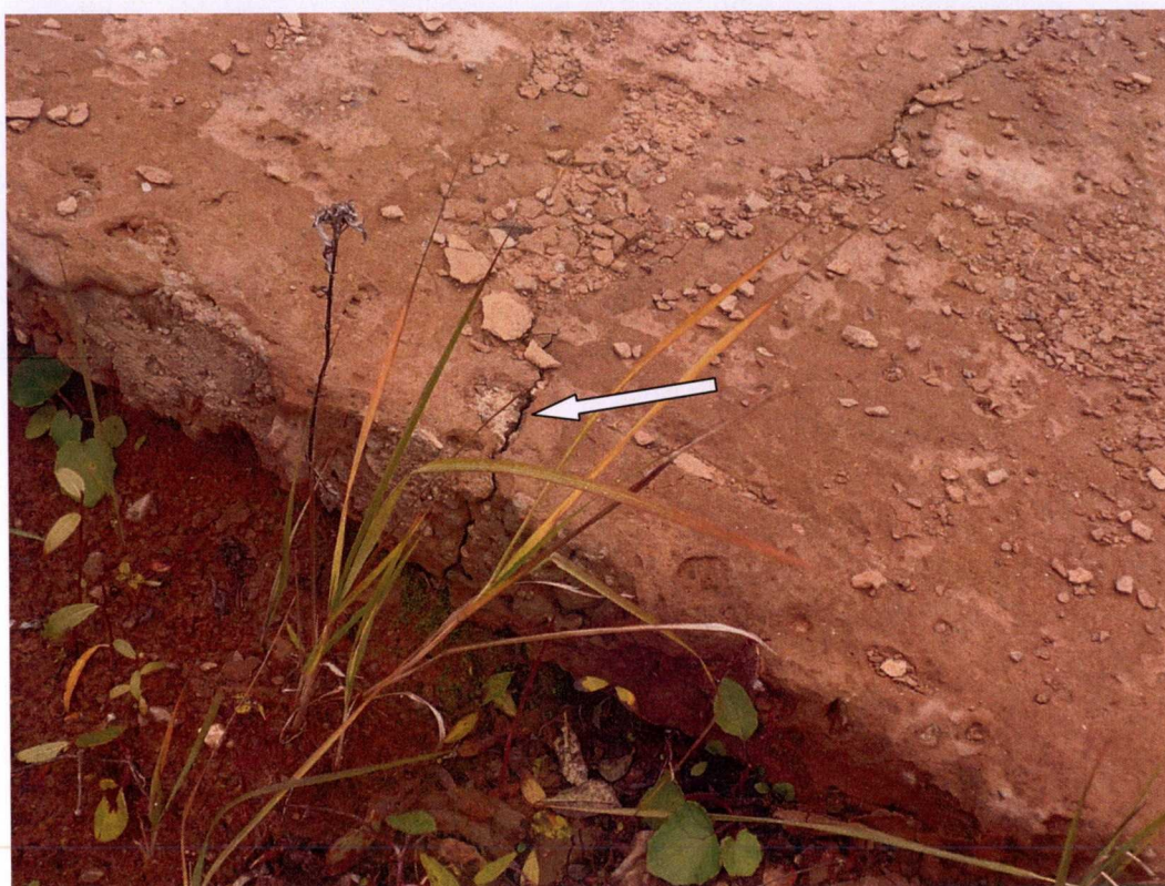
Фото № 6. Сквозная трещина в бетонной подготовке
