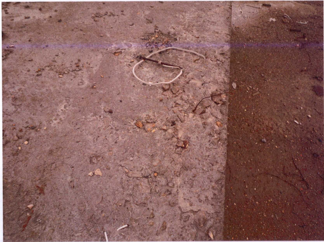
Фото № 9. Участок выветривания бетона фундаментной плиты в зоне секции 2
