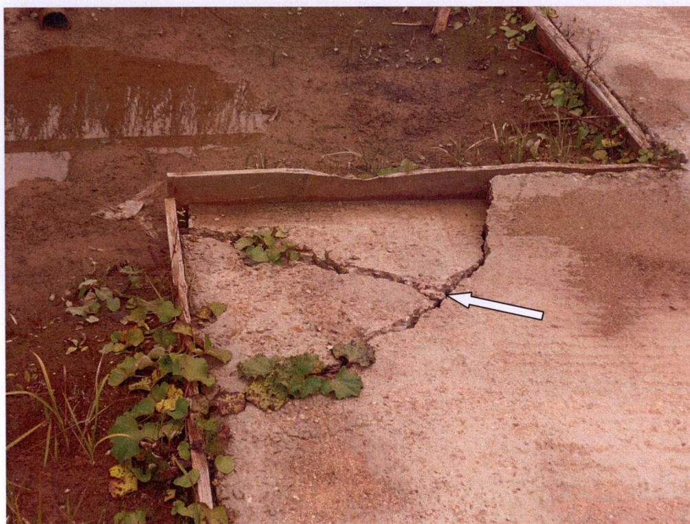
Фото № 4. Трещины в бетонной подготовке раскрытием до 1-5 мм, просадка бетонной подготовки до 5 см
