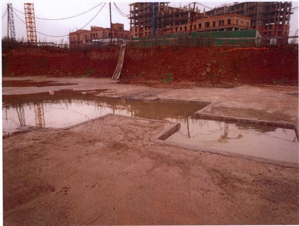
Фото № 14. Технологические разрывы в бетонной подготовке между секциями 5 и 6
