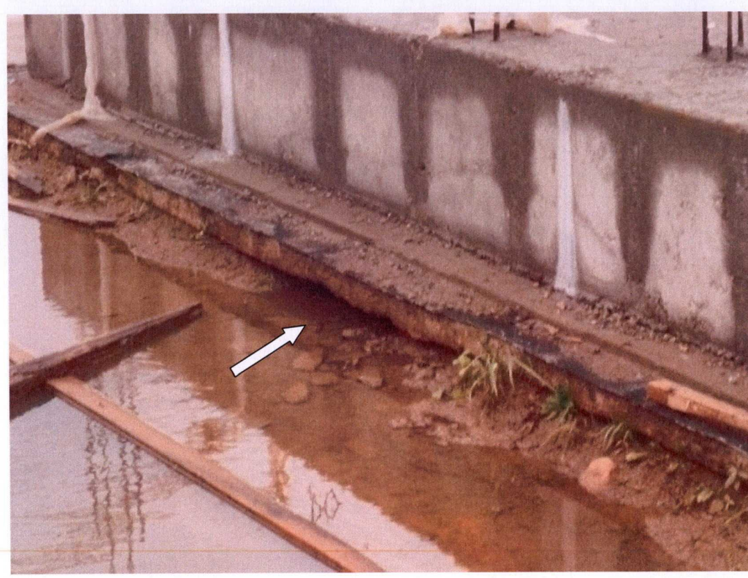
Фото № 8. Вымывание грунта из-под бетонной подготовки в зоне секции 3
