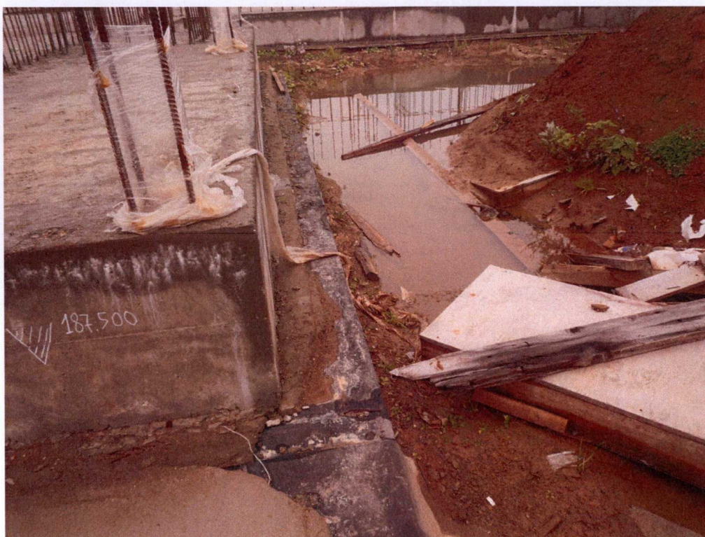
Фото № 19. Участок деформированной гидроизоляции
